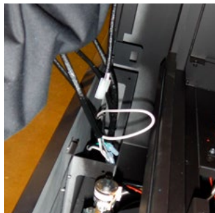
Figure 24.f Ventilateur, LED, PPO et fils pilotes dans le tiroir
